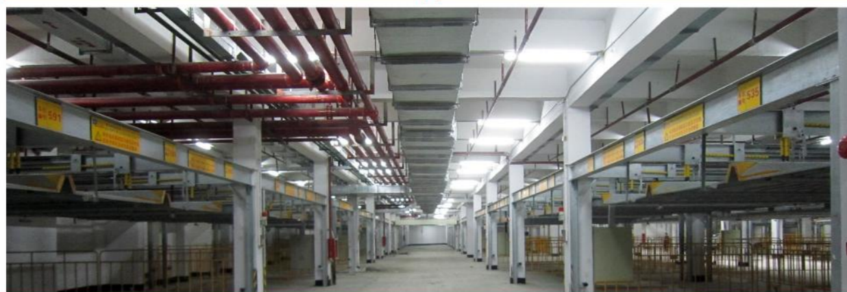
佛山海景蓝湾地下停车场
